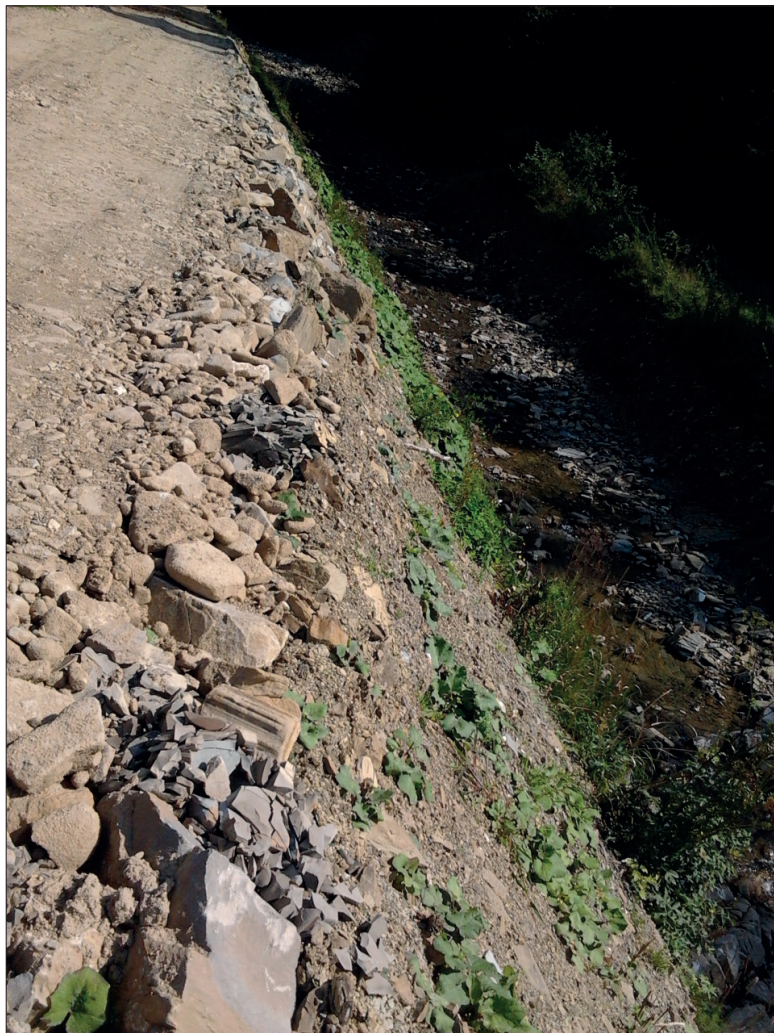
Fot. 2. Widok na podniesioną skarpe potoku
