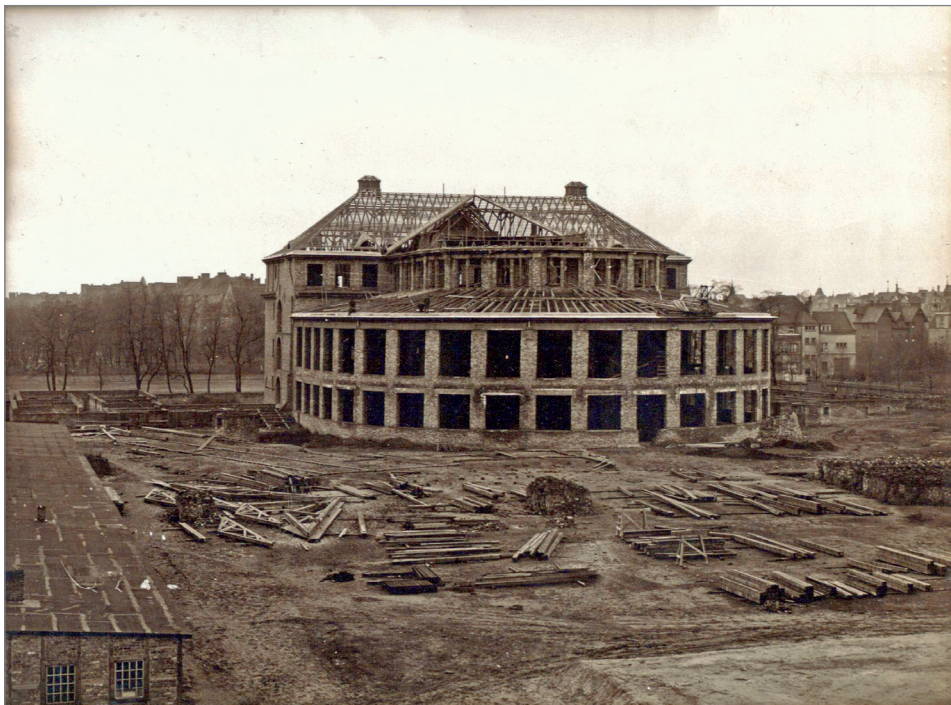
25. Fotografia przedstawia gmach Collegium Anatomicum podczas kontroli placu budowy w styczniu 1925 r. Budynek bez pokrycia dachu i zamontowanych okien i drzwi. Na placu budowy można dostrzec spory nieporządek.
