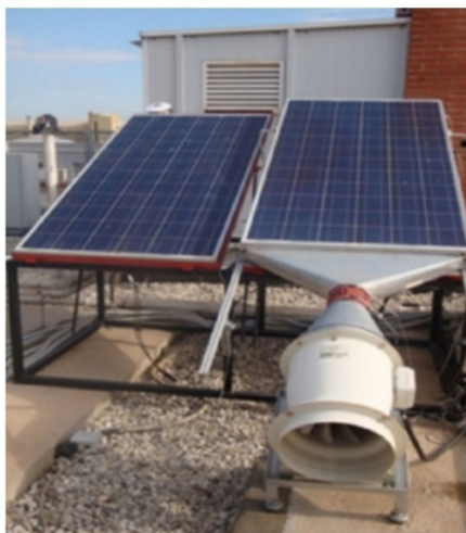
Zdjęcie 12. System chłodzenia powietrzem wspierany przez wentylator
