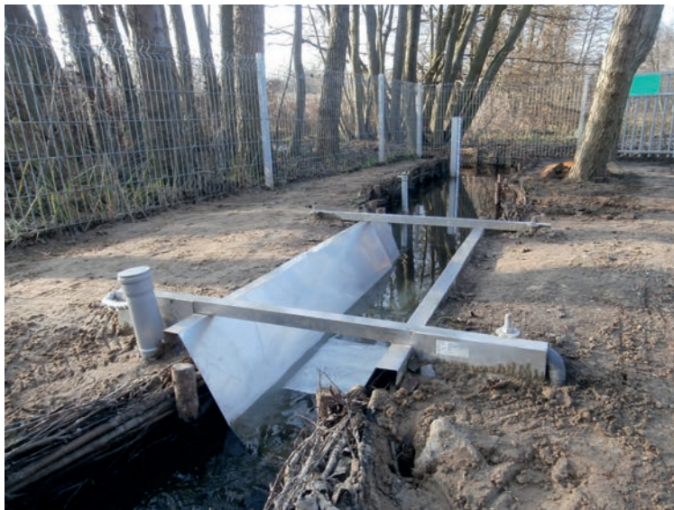
Ryc. 8. Posterunek wodowskazowy i koryto Parshalla zainstalowane w Różanym Strumieniu (fot. M. Majewski 2014)
