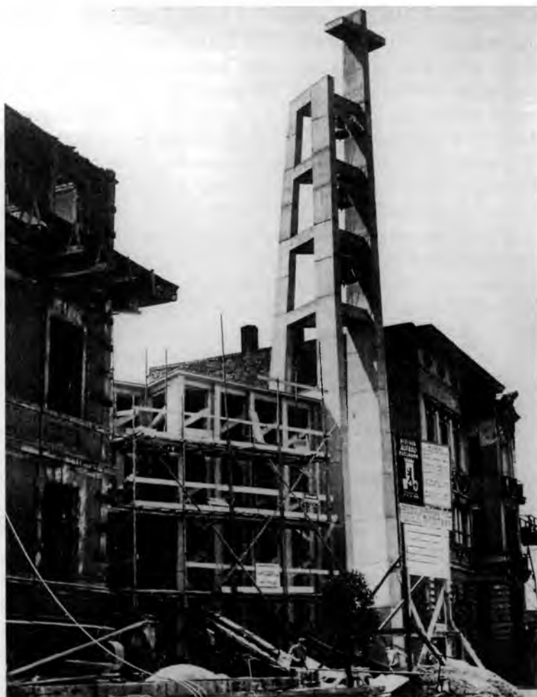
4. Kościół Św. Ansgara w czasie budowy (proj. W.Kreuer), 1956 (?) ( Interbau Berlin. Amtlicher Katalog , Berlin 1957)
